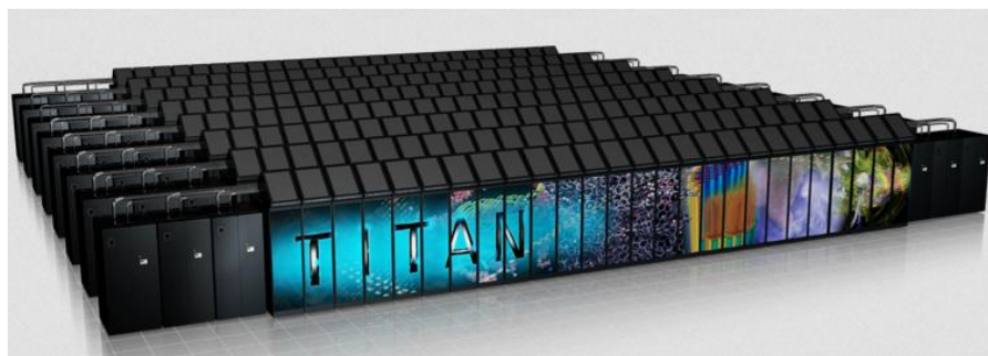
Titan, суперкомпьютер по типу MPP, построенный на серверах Cray XK7 для Oak Ridge National Laboratory в 2012 г.
