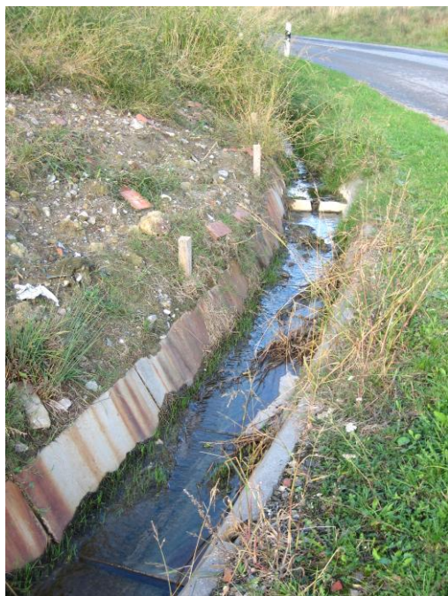
Рис. 8. Водоотводная канава по периметру полигона
